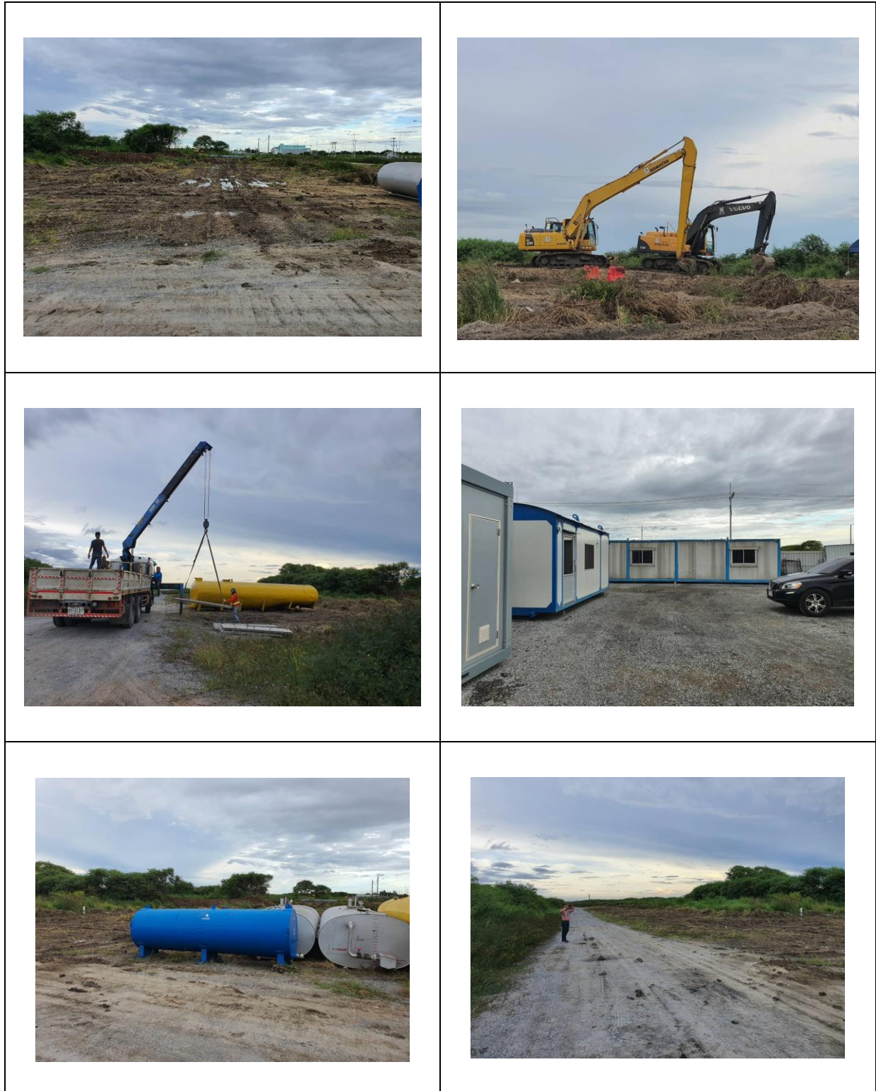
รูปที่ 7-1 แสดงความก้าวหน้าของการก่อสร้างอาคารสำนักงานโครงการของ CSC ประจำเดือนกันยายน 2563
